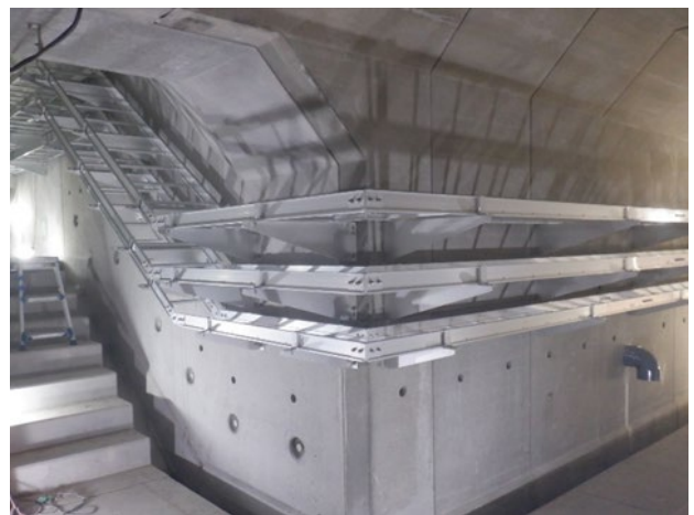
写真-1 監査廊ケーブルラック
