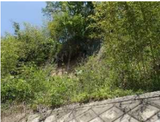
図-8 法面崩れ現地写真
