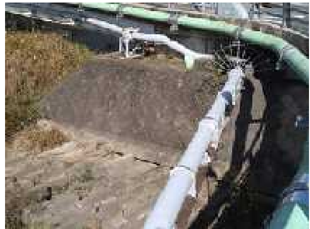
図-9 市道橋下の河床洗堀
