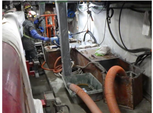
写真-8 排泥処理用設備
