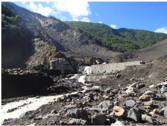
図-3 出水後の赤谷2号砂防堰堤の損壊状況 (2014年8月)
