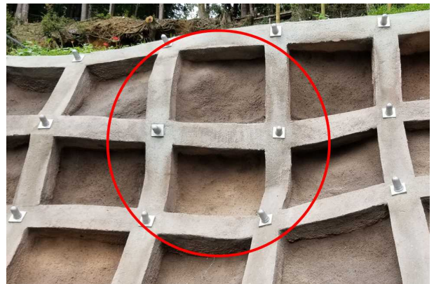
写真-2 法枠屈曲・湾曲部
