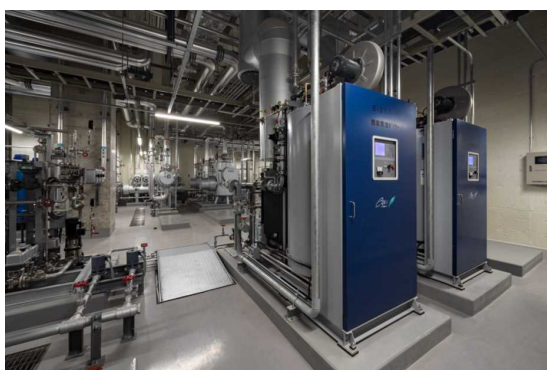
写真-2 地下1階熱源機械室
