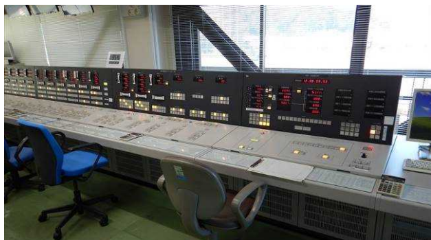
写真-2 表示設定操作卓・遠方手動操作卓
