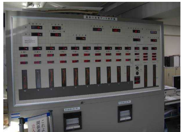
写真-3 グラフィックパネル (旧設備)
