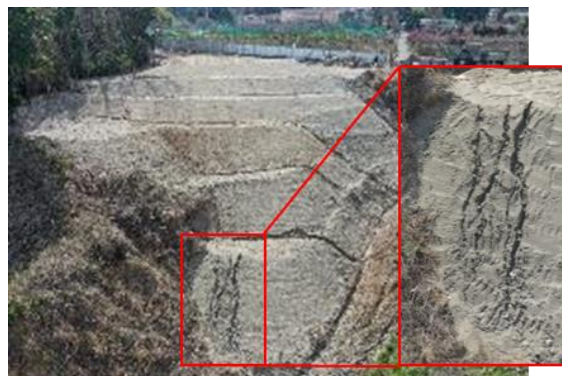
写真-1 法面部におけるガリー発生状況
