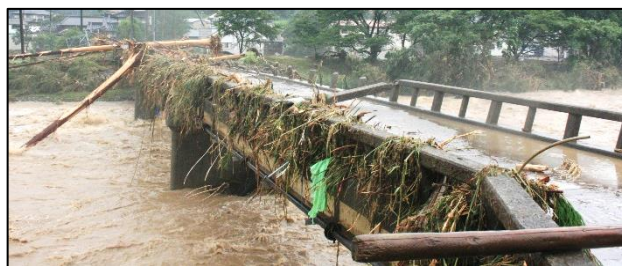
写真-1 2009年台風9号での流木による橋の損傷
