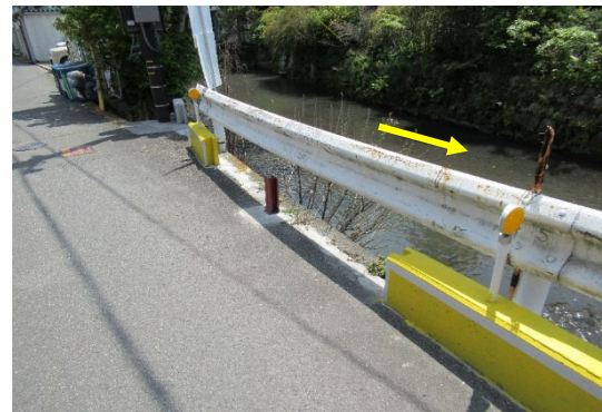
写真-3 止水版設置施設
