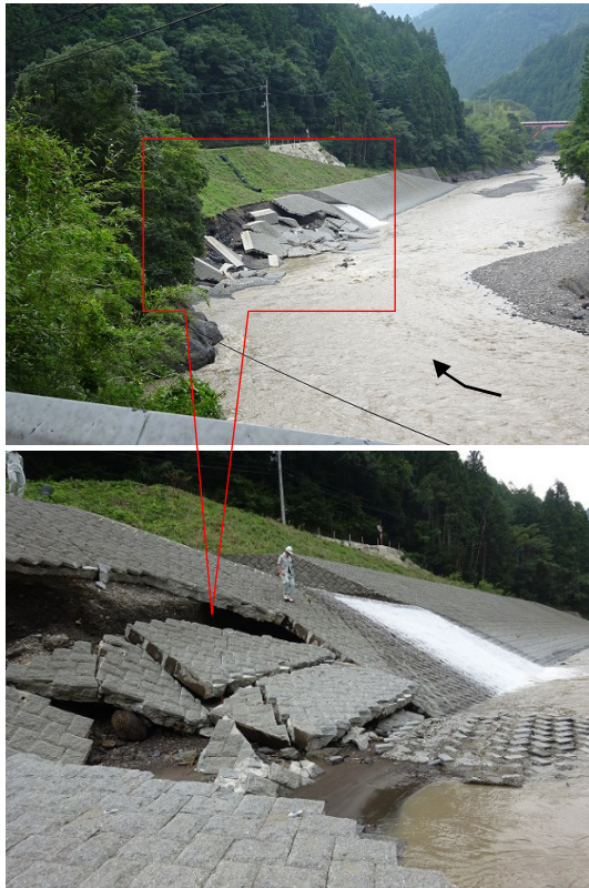
写真-3 西川 (十津川村永井) 河床洗掘による背面土砂流出、ブロック折損
