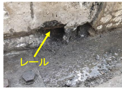
写-5 調整コンクリート空洞状況(左)
