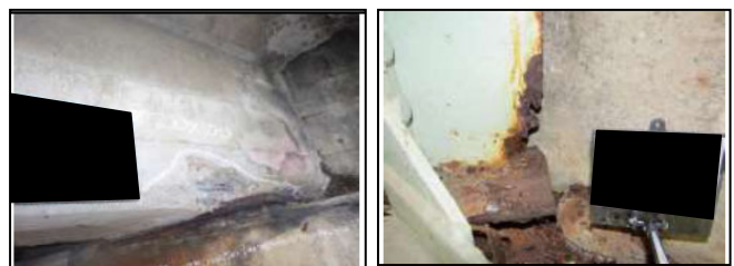
A橋の損傷例
