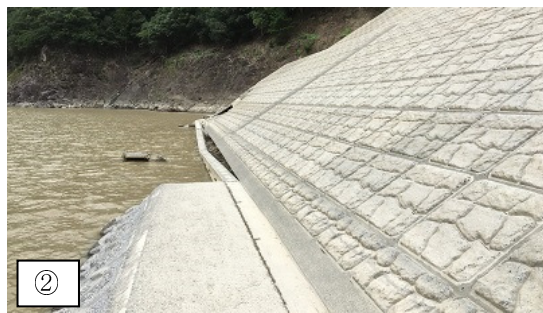
写真-5 2018年度被災状況
