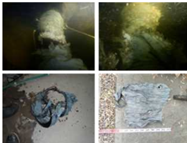
図-6 羽根車に噛込んだビニルシート片
