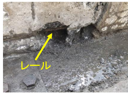
写-5 調整コンクリート空洞状況(左)
