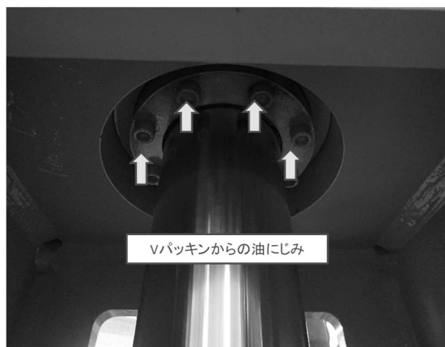
写真-2 Vパッキンからの油にじみ状況
