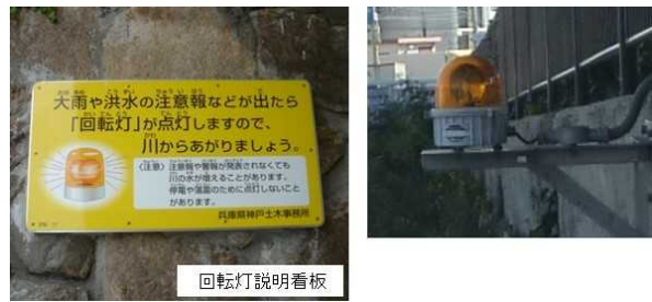
図-6 避難誘導ランプ
