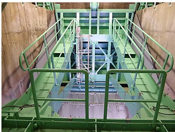
写真1 常用洪水吐き設備主ゲート
