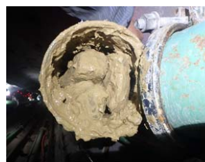
写真-2 排泥吸引管の閉塞状況
