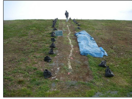
写真-1 地盤改良の境界に発生したクラック（隣接工区）
