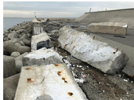
図-5 護岸上部の転倒(1期南側護岸)
