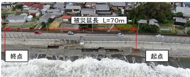
写真-2 被災全景
