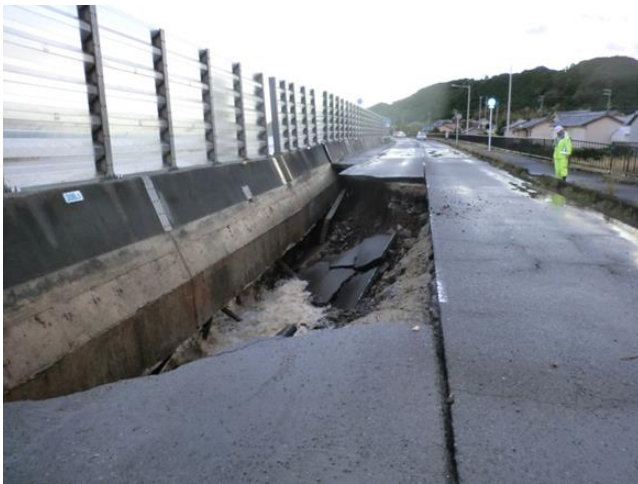
写真-1 被災状況
