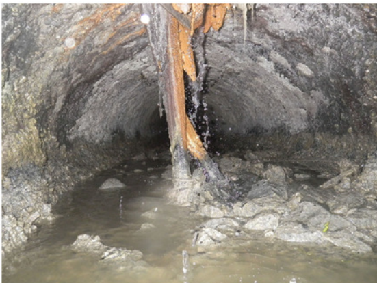
写真-1 下水道管腐食による土砂侵入被害
