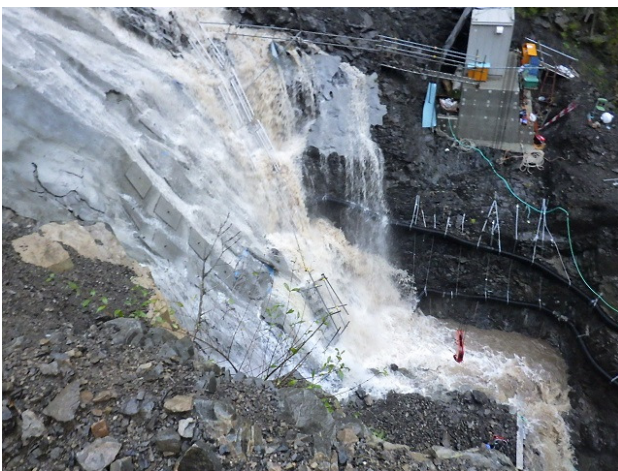
図4 降雨後の流水状況
