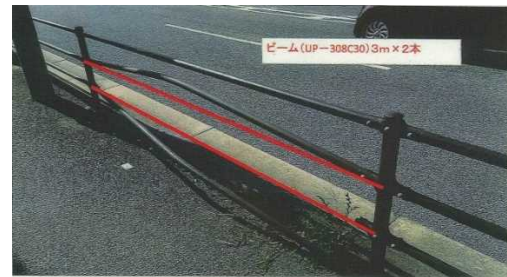
写真-1 道路損傷の例（歩道柵）
