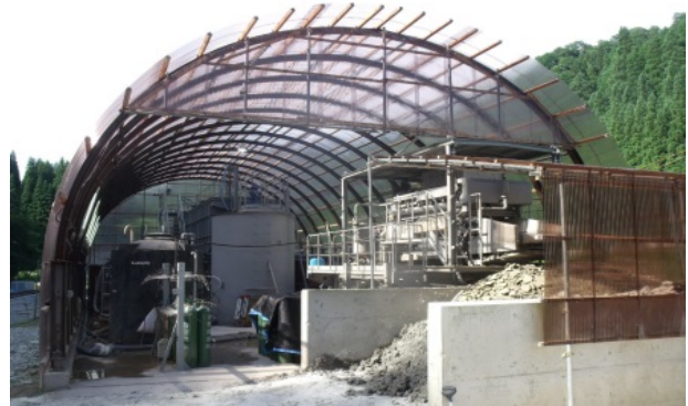
図-7 濁水処理施設
