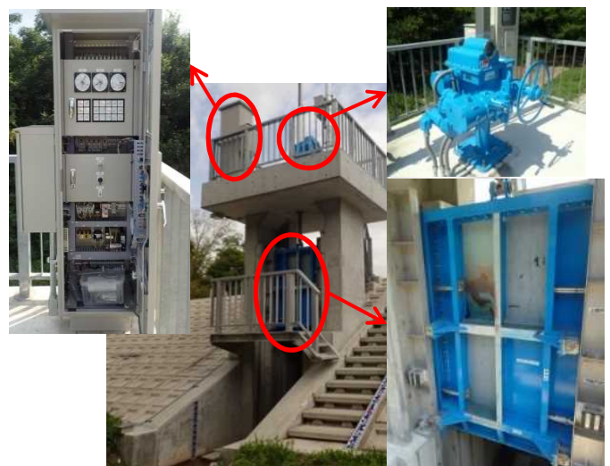
写真-1 訓練用ゲート設備の全景
