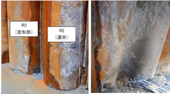
図-16 鋼管矢板の変状
