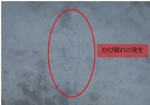
図-3. 若材齢時での脱型によるひび割れ
