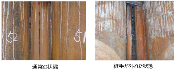
図-15 継手の変状
