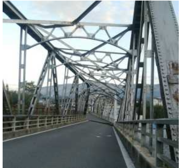
写真4 被災状況②
