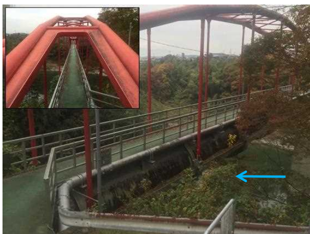
写真5 水管橋の利用
