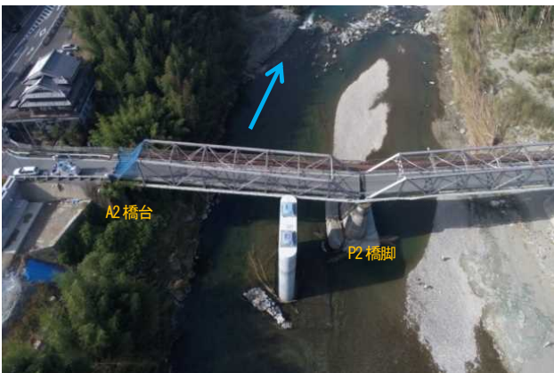
写真3 被災状況①
