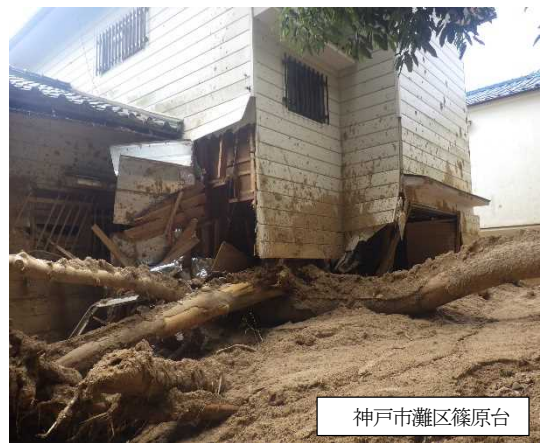
図－7 谷出口直下の家屋被災状況
