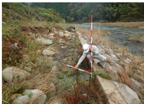
図-2 護岸天端の洗堀
