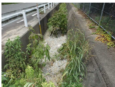
図4 漏水とともに噴出した土砂
