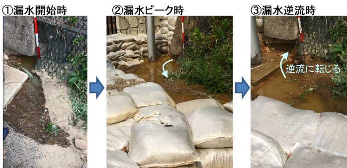
図-14 漏水の様子
