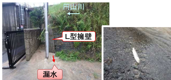
図-4 漏水時の状況
