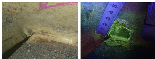
写真-2 パターン①の塗膜割れ
