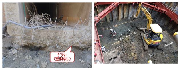
図-21 函渠周辺の状況
