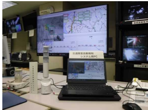
写真-9 AIカメラを用いたCCTVカメラの監視
