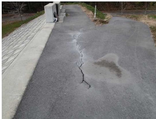
図-15 堤防天端に縦断方向に生じる亀裂の再現
