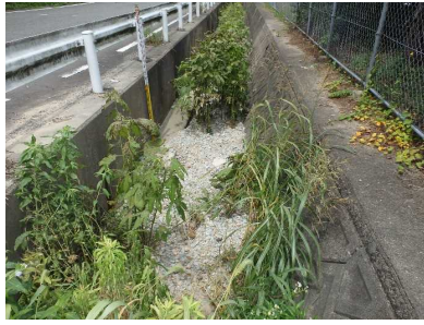
図4 漏水とともに噴出した土砂
