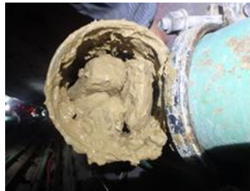
図-3 送泥管の閉塞状況
