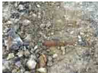
写真3 床版土砂化状況
