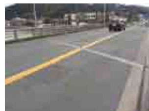
写真 1 舗装損傷状況
