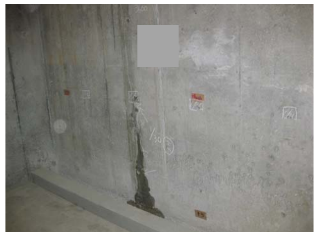
写真-13 漏水箇所例
