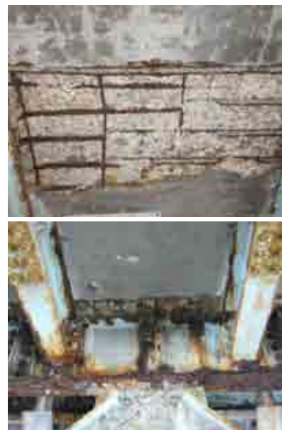
写真-1 床版や橋桁の損傷状況
