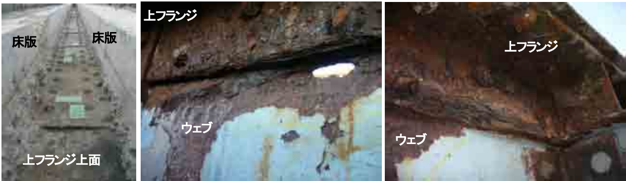
写真-4 床版に埋もれている主桁上フランジ及びウェブ上部の状況
