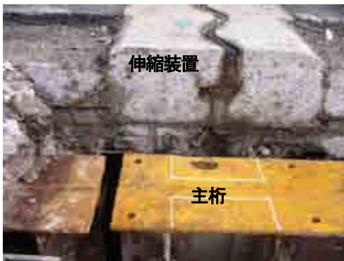
写真-5 伸縮装置の下部について腐食が著しい
