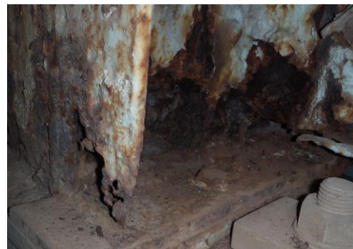
写真-6 腐食による孔食状況
