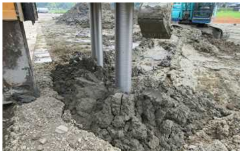
図-9 吹き上がり土の様子
