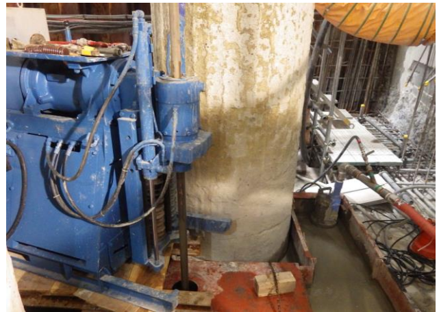
写真-12 排泥クローズドシステム
