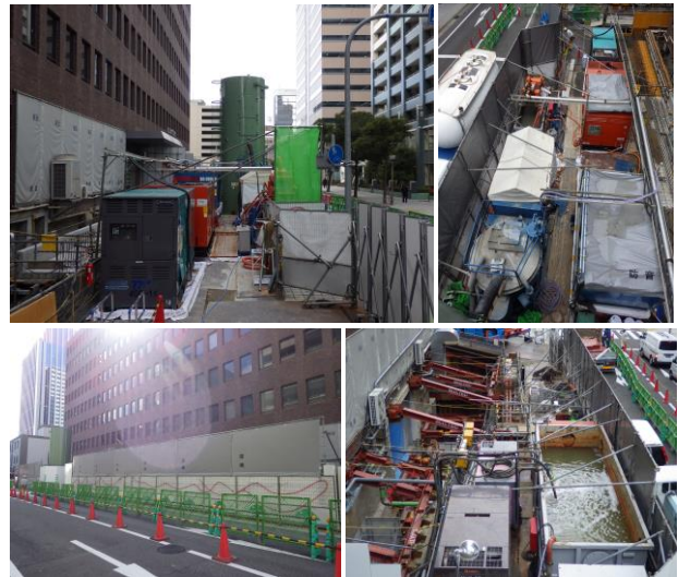
写真-11 プラント全景
