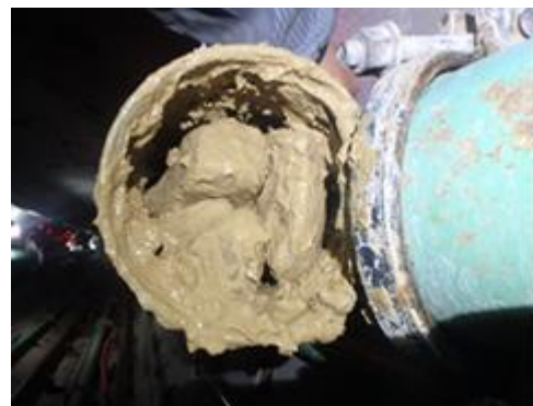
図-3 送泥管の閉塞状況
