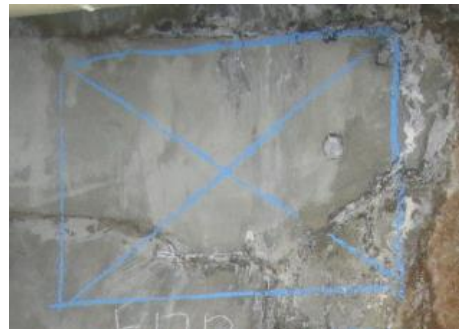
写真-1 劣化部の状況
