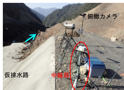
図-16 中継局の設置状況
