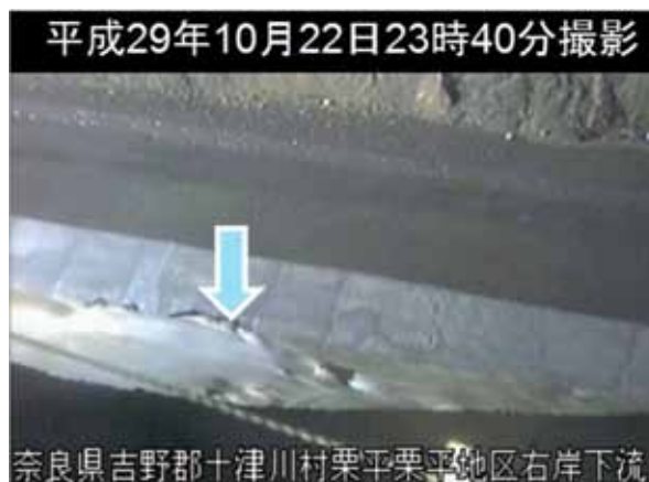
写真-3 台風 21 号時の CCTV 映像 矢印は侵食が発生していると思われる箇所を示す
