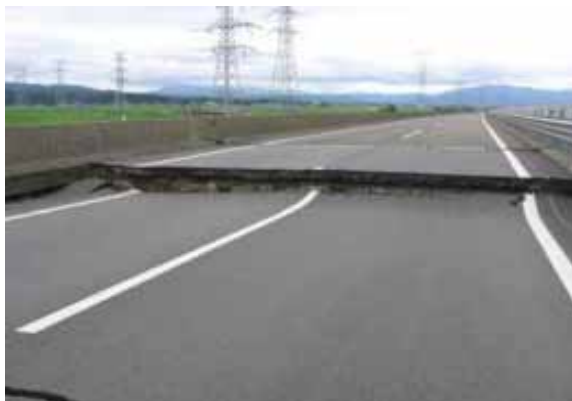
図-1 中越沖地震で発生した路面段差 1)
