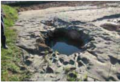
写真6 漏水後の陥没状況 (R5地点)
