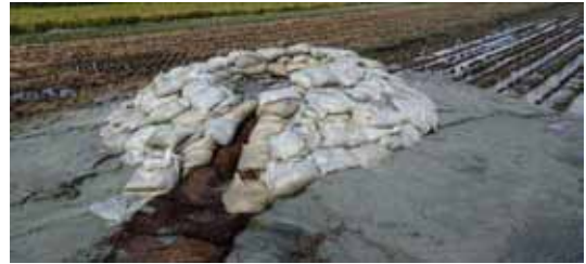
写真-4 水防活動による釜段と噴砂の状況 (R5地点)
