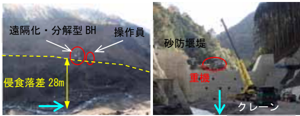
図-6 侵食状況と重機搬入状況
