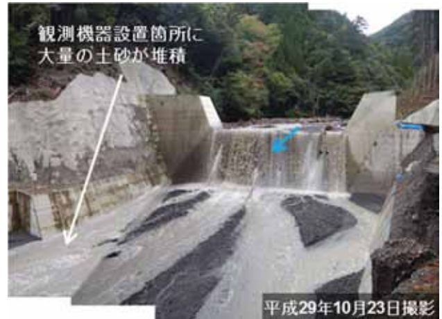
写真-2 台風21号後の観測箇所周辺の状況 観測箇所周辺を下流側より撮影
