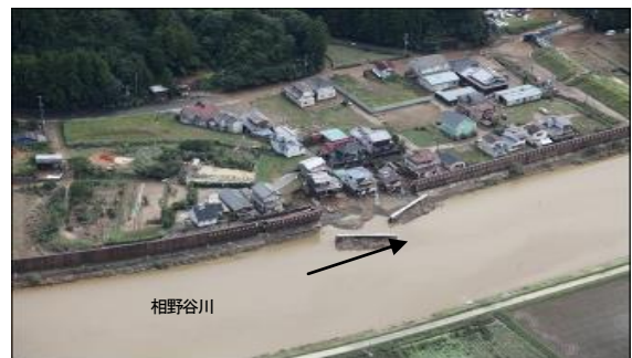
写真-1 高岡輪中堤の転倒
