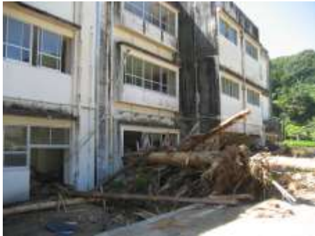
図-4 小学校（避難所）の被災状況
