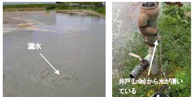
写真-5 漏水状況 (R5地点)
