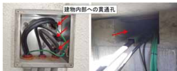
図-5 外壁に設置されているプルボックス内部(左)、電気ハンドホール内部(右)
