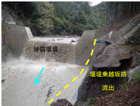
図-3 台風通過後の砂防堰堤
