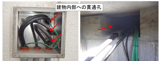
図-5 外壁に設置されているプルボックス内部(左)、電気ハンドホール内部(右)
