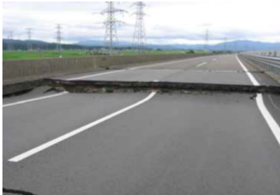
図-1 中越沖地震で発生した路面段差 1)
