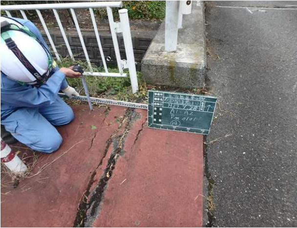
写真-05 橋面 遊歩道との段差 95mm
