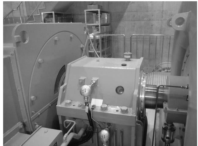
写真-1 振動センサー（水車側軸受け）
