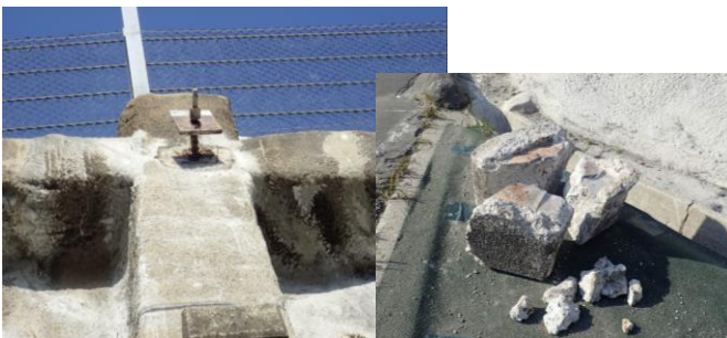
写真-1 アンカー飛び出し状況及びコンクリート片
