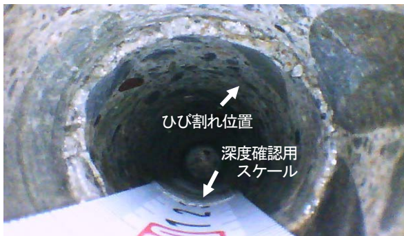
写真-2 観察孔内のひび割れ位置の確認
