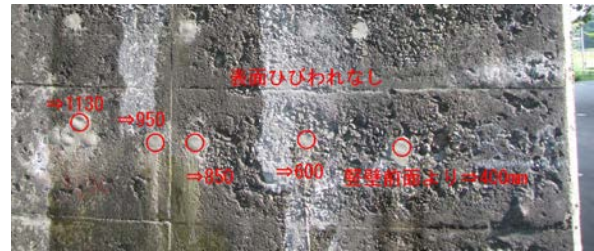
図-5 A1(上)ウイング接合部ひび割れ調査の結果
