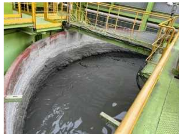
泥水攪拌貯蔵槽
