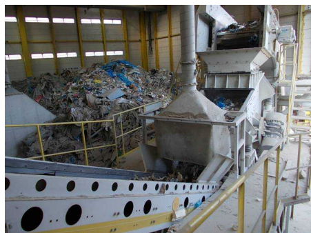
プラントの様子
