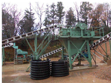
プラントの様子
