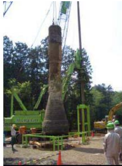
写真-1 掘り出した杭状況
