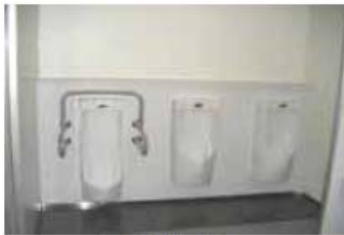
システムトイレ
