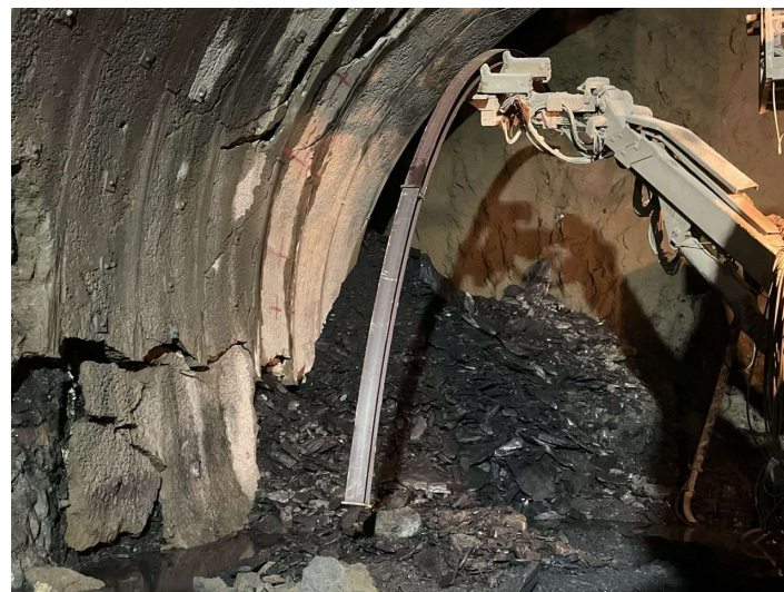
写真3 土砂流出の状況
