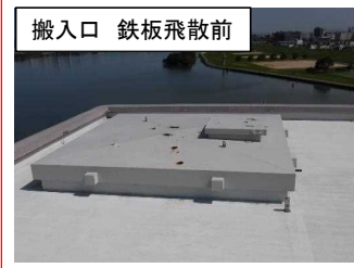
搬入口鉄板飛散
