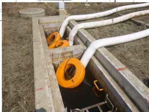
▲第3排水区排水ピット(9/6 13:09)
