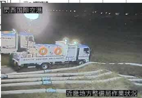
▲第3排水区照明映像 (9/6 2:46)
