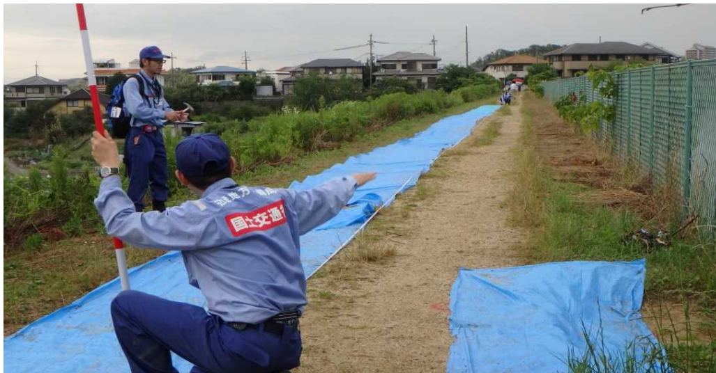
6/19 枚方市長尾東町での被災状況及び応急復旧状況調査
