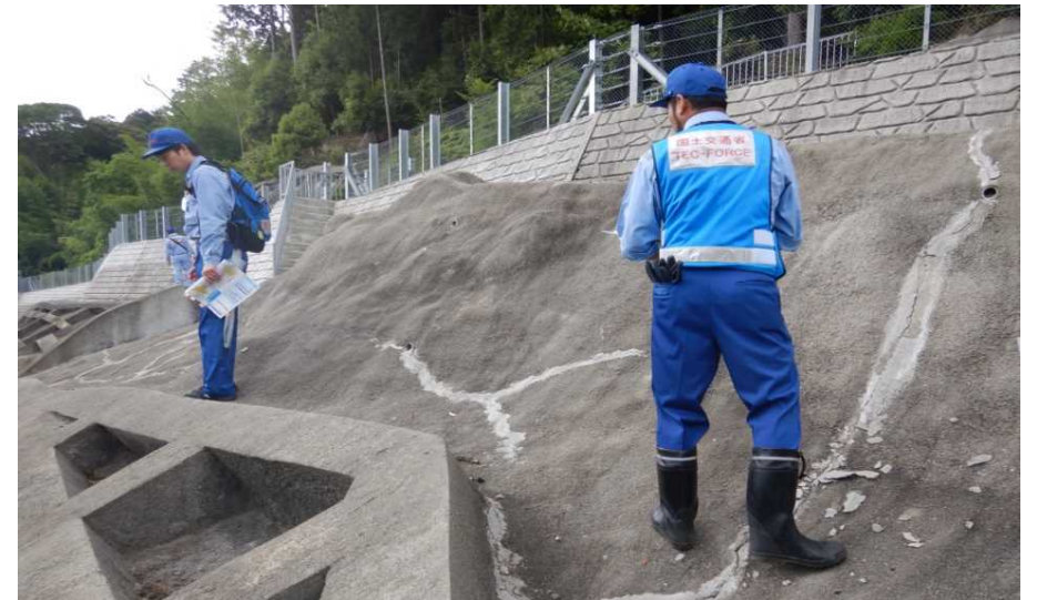
6/19 高槻市原での法面被災状況調査
