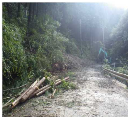
▲堺かつらぎ線(和泉市善正町)で発生した法面崩壊の状況
