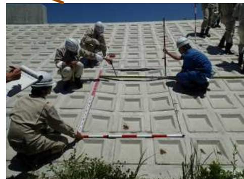
護岸の変状調査
