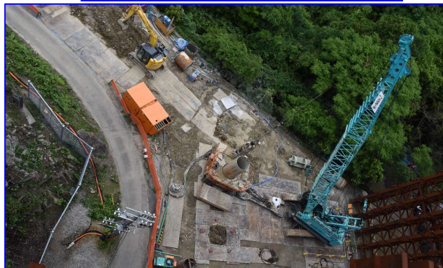
硬質岩によりビットが損耗し掘削難航
