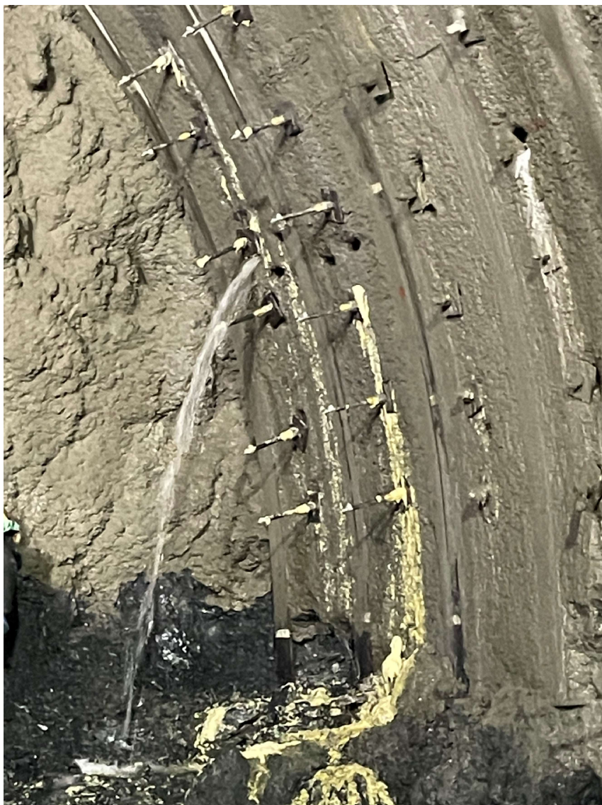
■ 写真1 12月19日に発生した突発湧水（大谷トンネル）
